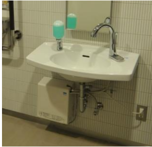
כיור ומתחתיו מיכל המחובר למשאבת ניקוז
